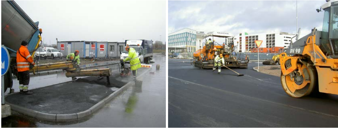
Bild 6-9 En refug och trafikerade ytor belades med samma OTA-massa på ett exploateringsområde vid Hyllie tågstation i Malmö en blåsig och kylslagen novemberdag 2010.
